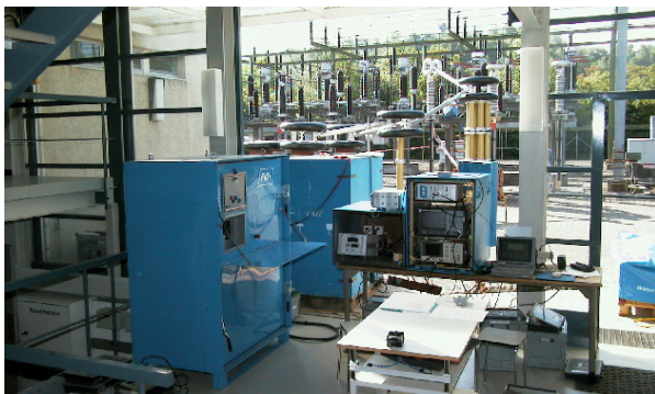
Convertisseur de fréquence et appareils de mesure de DP
