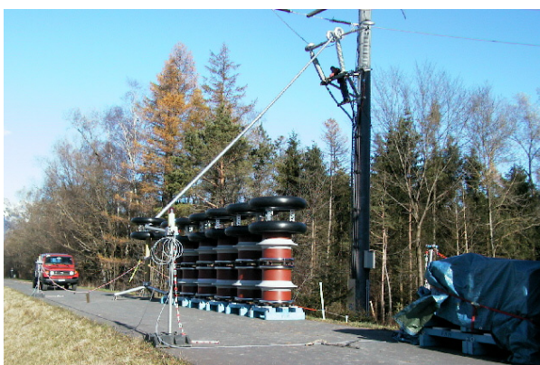
Essai de câbles avec alimentation HT sur pylône de fin de tronçon
